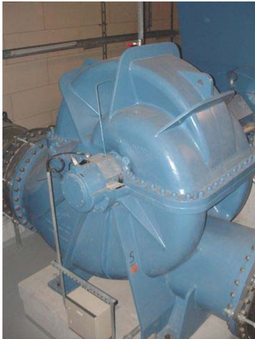
Nijhuis Effluent Pumps 5 x 12000m 3 /h
