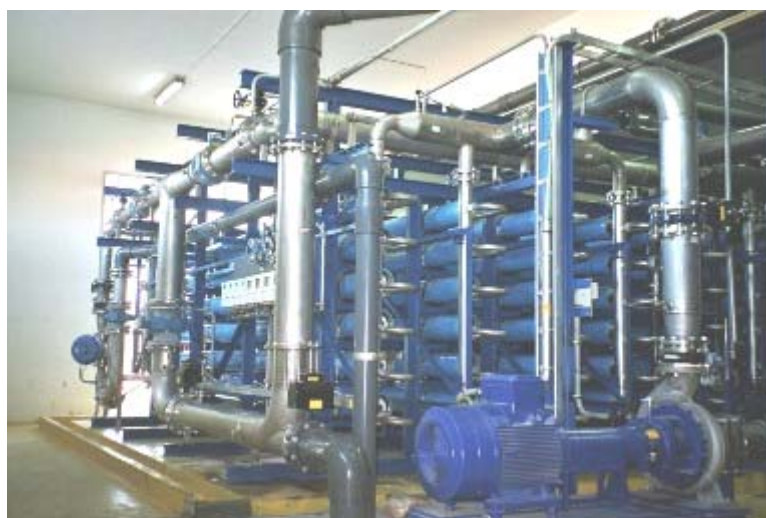
De nieuwe 4 e lijn met interstage boosterpomp
